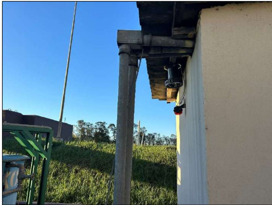
Figura 28 - Sirene instalada na ETE.
